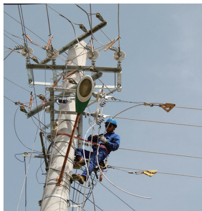
赵镇供电所低压运维工进行更换导线作业，维护线路安全
