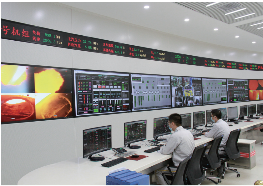
调度中心监控员紧盯全厂设备运行情况
